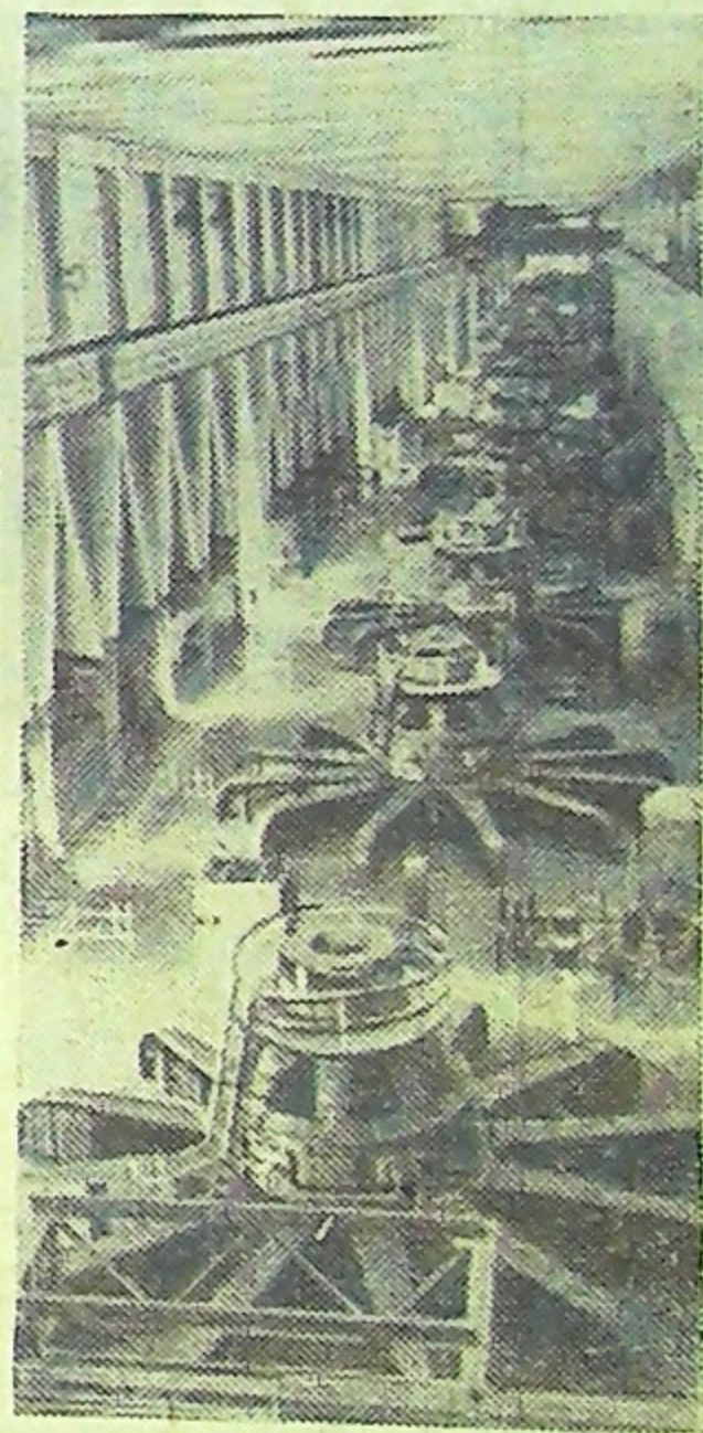
Братская ГЭС. Машинный зал.
