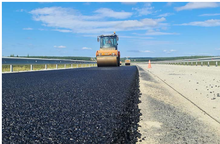
За пять лет в нормативное состояние приведено более тысячи км дорог. В этом году ремонт завершится еще на 200 километрах
